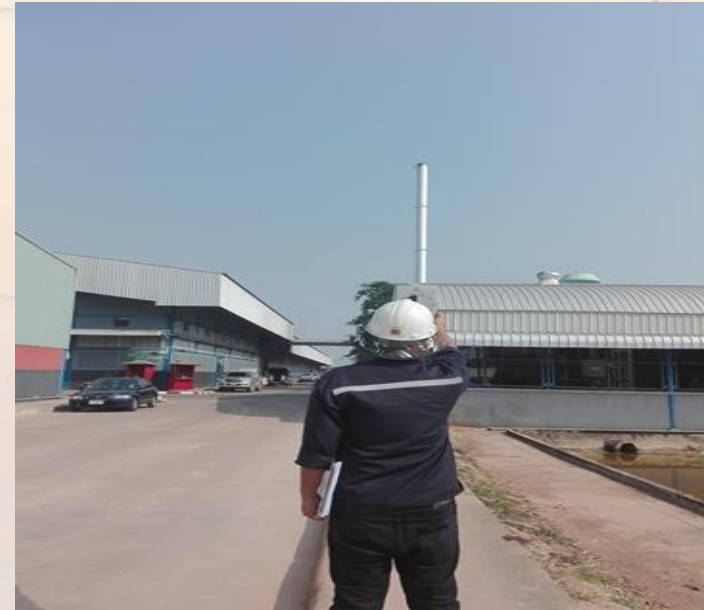
ปล่อง Boiler
