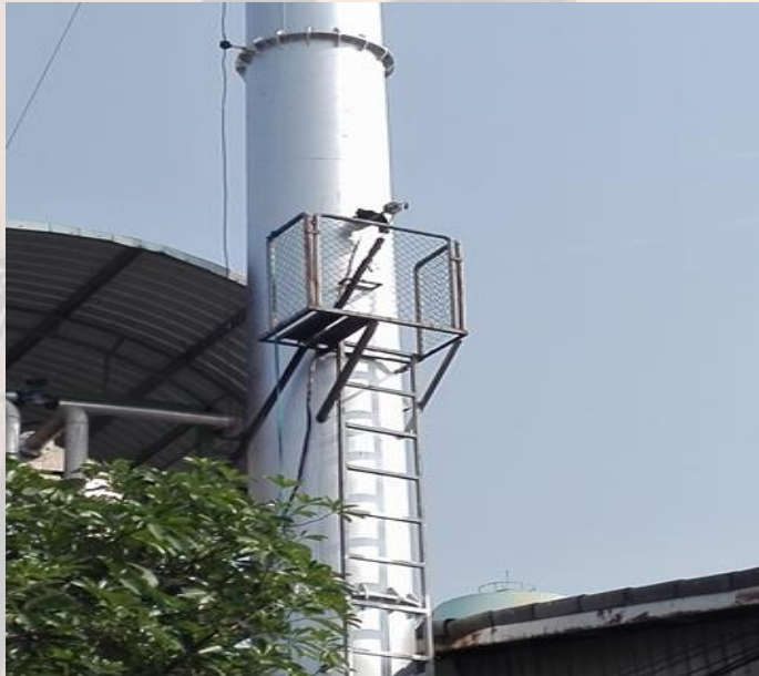
ปล่อง Boiler
